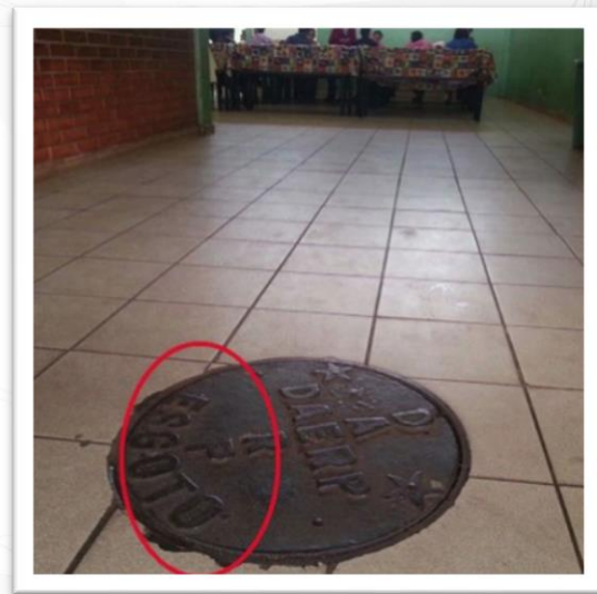
ESGOTO TRANBORDANDO NA COZINHA EM PERÍODOS DE CHUVA
